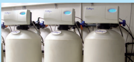
Particolare del pre- trattamento
